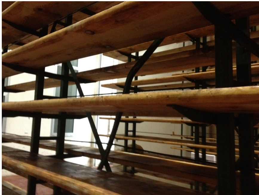
Diagonale di controvento danneggiata dopo l'evento sismico
