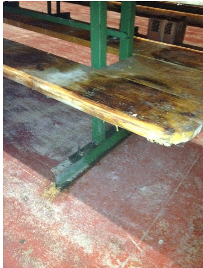
Assenza di ancoraggio alla pavimentazione
